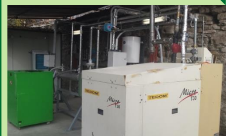
Impianto di mini biogas
